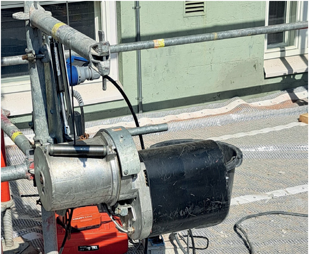
Kuvassa sähkötoiminen nostolaite.
