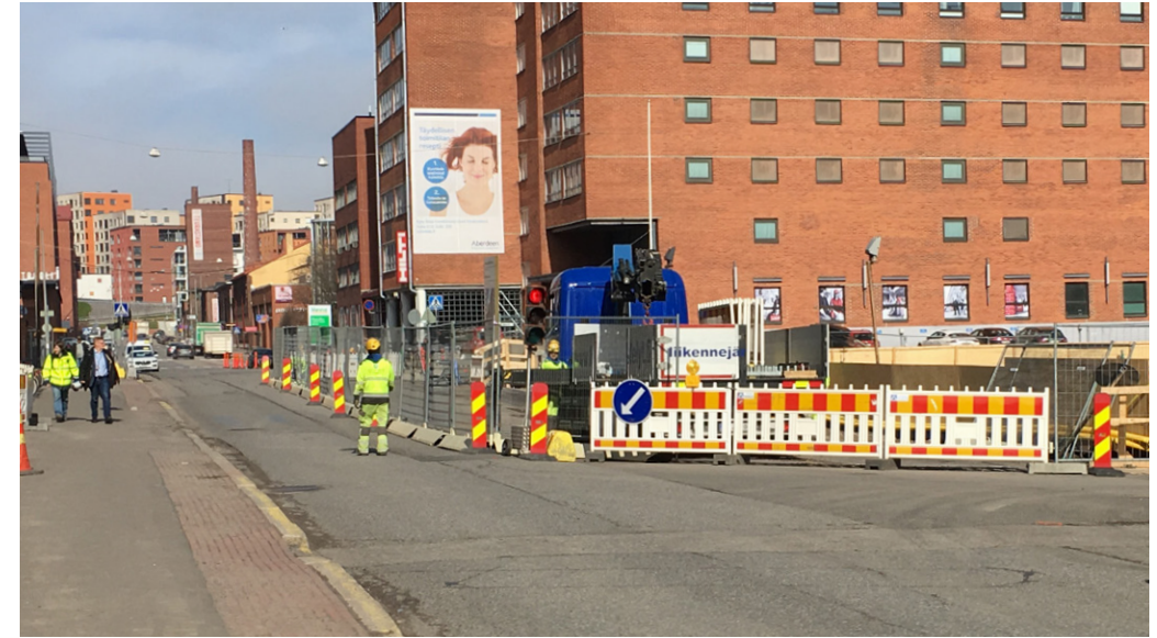
Yleisen liikenteen turvallisuus pitää taata mahdollisimman hyvin. Työmaaportit sijoitetaan niin, että kulku portista yleiseen liikenteeseen sujuu turvallisesti.
