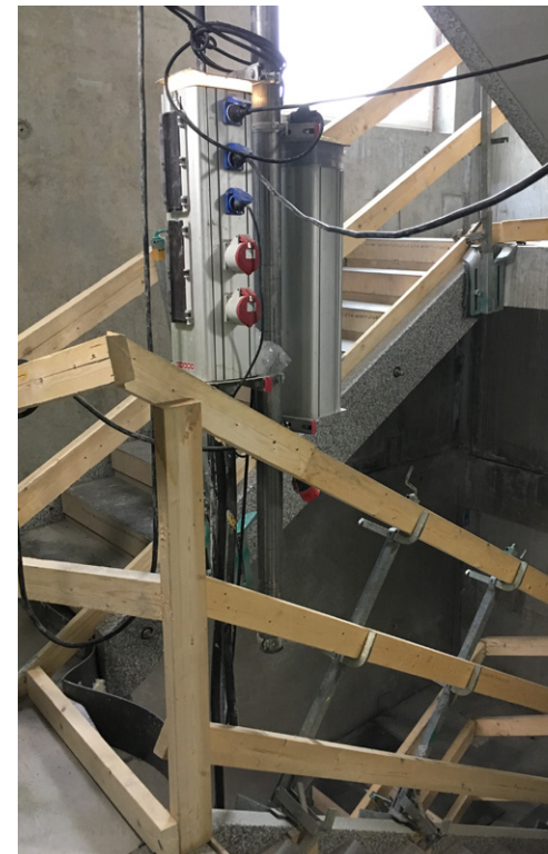
Sähkökeskukset, johdot ja valaistus oikein sijoitettuina porrashuoneessa.
